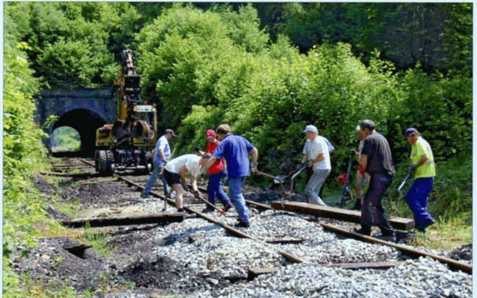
Le 7 juin, remplacement de traverses entre les tunnels de Lèche (en arrière-plan) et de Purnode. PFT.
