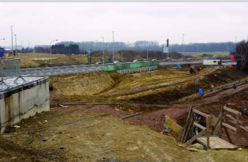
5 Encore une vue prise depuis l'avenue de l'Aéroport, mais en direction de Mechelen. La construction en béton visible à gauche est située à l'emplacement initial de l'E19. Ce pertuis du tunnel a pu être construit après le détournement provisoire de l'E19 visible au milieu de l'image.
