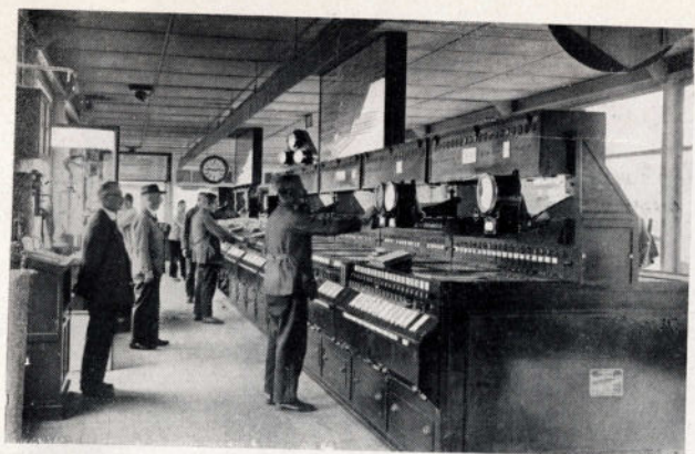
Photo 19 — Intérieur d'une cabine électrique
