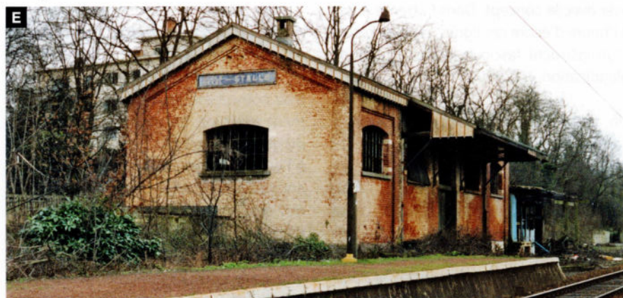
e. Une halle de type classique: cinq travées au total, un jeu de maçonnerie fait de contreforts et de murs en retrait ; des fenêtres – non ouvrantes – aux croisillons métalliques (Uccle-Stalle, ligne 124)
