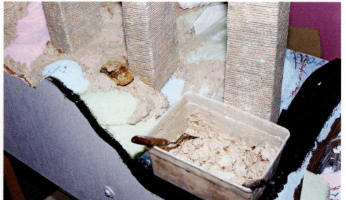
Sur la couche de mousse dure vient s'appliquer une couche de pâte constituée de fibres de bois et de plâtre, appliquée à la spatule.
