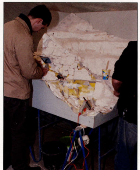
Dans un froid de canard, les constructeurs collent des moulages de plâtre sur la base en glueshell au moyen de pistolets à colle et de colle thixotrope.
