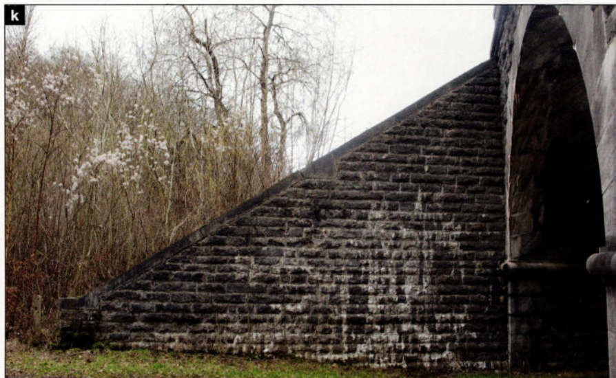
Foto k: L'effet général de ces coulures est bien visible ici, sur le mur de retour du pont de Sponstin source. Remarquons aussi l'angle du couvre-mur, équivalent à l'angle du talus qu'il termine (environ 35 degrés), la pierre triangulaire en son milieu et le replat à sa base, prévus pour empêcher le glissement.
