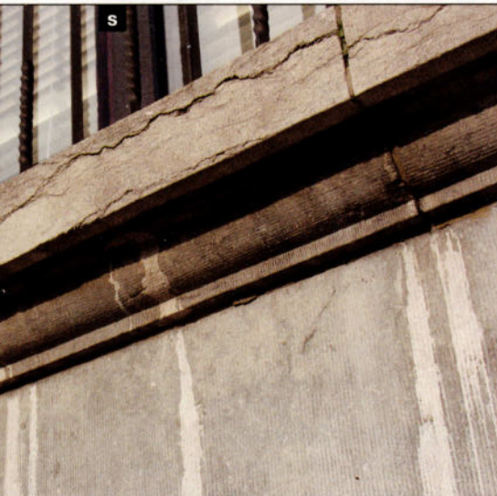
Photo s: Une spécificité dans le trajet de l'eau sur un mur suffit à provoquer des traces caractéristiques. Ici, nous pouvons observer l'origine de tel coulures, soit, de gauche à droite : une lacune dans le rejet d'eau, une simple petite fissure et le joint de l'appui de fenêtre.
