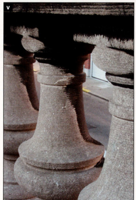
v Photo v: Cette vue est réalisée sur un pont datant des débuts du chemin de fer et situé à Laeken, où il enjambe la ligne 50. Le plan rapproché illustre le grand contraste entre la pierre lessivée et sa patine noirâtre. A la frange apparaît même une zone encore plus éclaircie.
