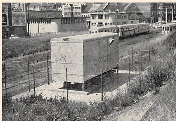
Te Oostende, aan de Brandariskaai, werd door onze diensten een verplaatsbaar elektrisch onderstation geïnstalleerd dat onze kustlijn van stroom voorziet.
