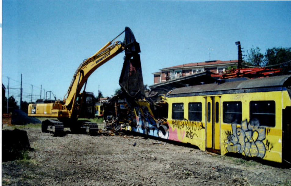
La 228 072 en cours de démolition à Modena Piazza Manzoni le 18 juillet 2016. Giuseppe MARCIALIS.
