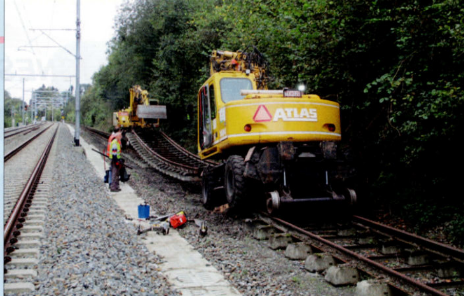
Les coupons de voie étaient amenés un par un par deux grues et placés les uns derrière les autres. Cette photo montre l'arrivée du dernier coupon le 30 septembre 2016. PFT-CFB.
