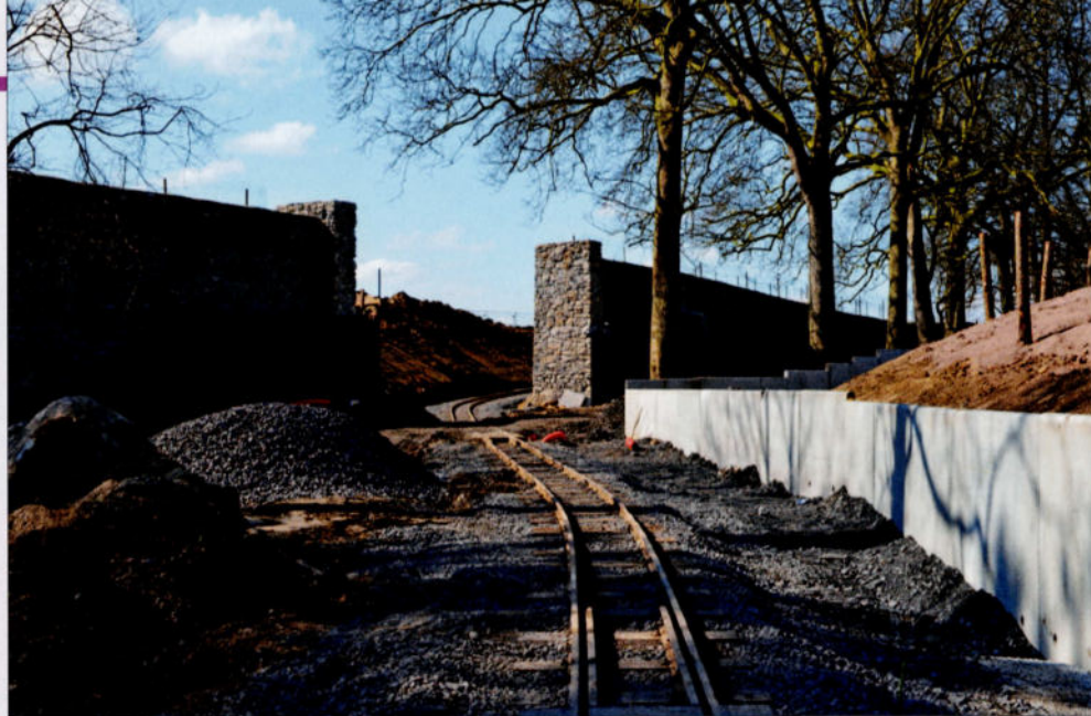
PHOTO 127-49 Pour sortir du parc et traverser le futur royaume des éléphants, deux brèches ont été réalisées dans le mur d'enceinte. Gwenaël PIÉART.
