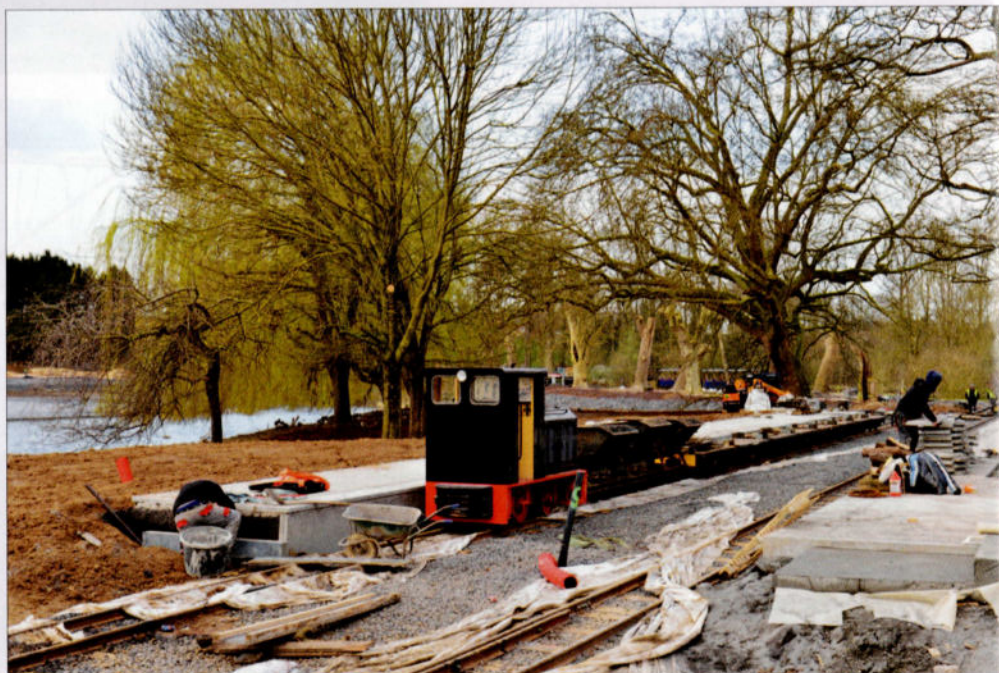
PHOTO 127-48 Le 1er avril 2015, les ouvriers s'activent à terminer les travaux du réseau avant l'ouverture du parc le 11 avril. On voit ici les travaux de finition de la gare, à l'aide de la locomotive Diesel Diema. Pierre HERBIET.
