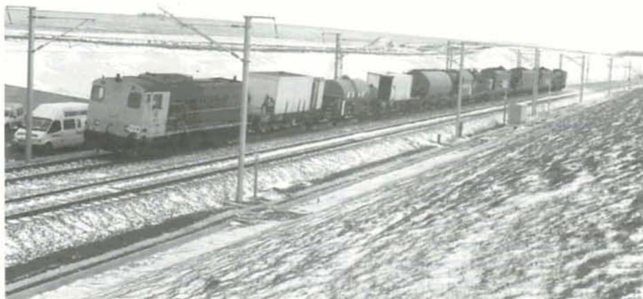
PHOTO 26-26 Malgré le rude hiver que nous avons connu, les trains de travaux opéraient sur la ligne nouvelle, comme le train bétonneur de la firme SCLE, encadré par deux 76, le 21 février.
