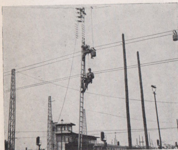
Fig. 25. — Bruxelles-Midi : équipement d'un grand portique souple.
