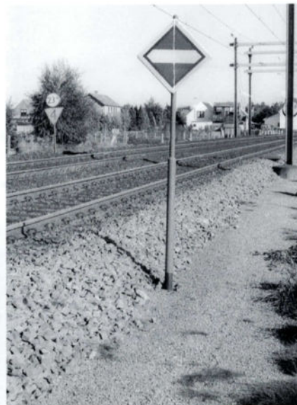
Ce panneau impose aux conducteurs d'abaisser leur(s) pantographe(s), avant le franchissement de l'écluse électrique.
