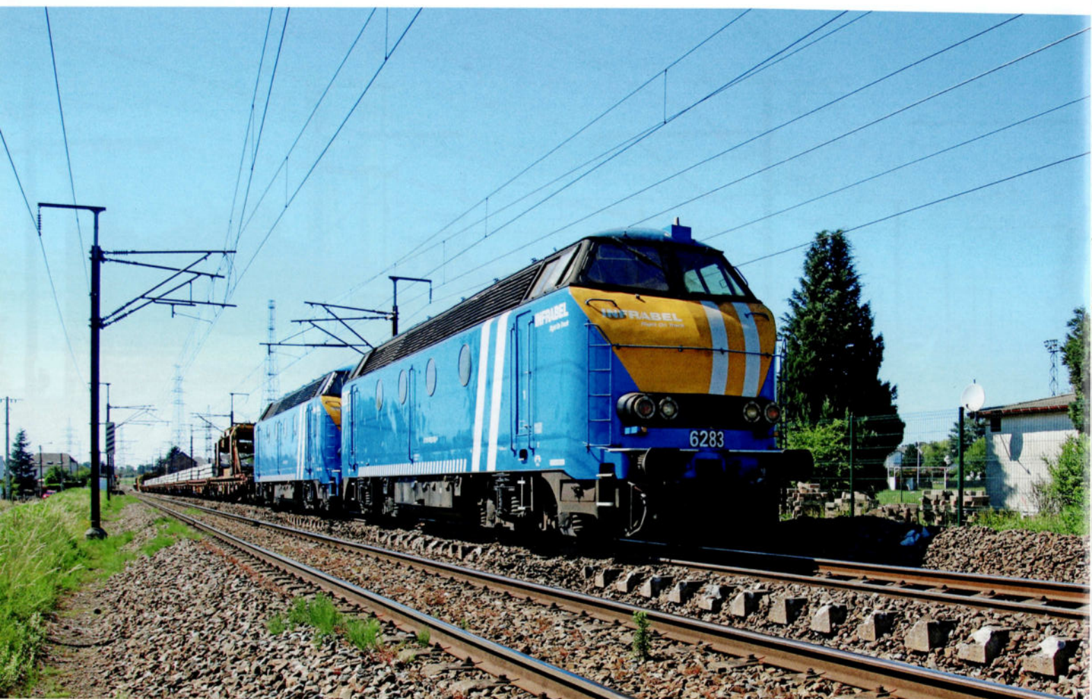
Le train de renouvellement P811 à l'œuvre à hauteur de la gare d'Aubange, remorqué par les 6283 et 6237 d'Infrabel. On distingue devant la locomotive les dégâts causés aux traverses en béton par les roues du convoi déraillé...
