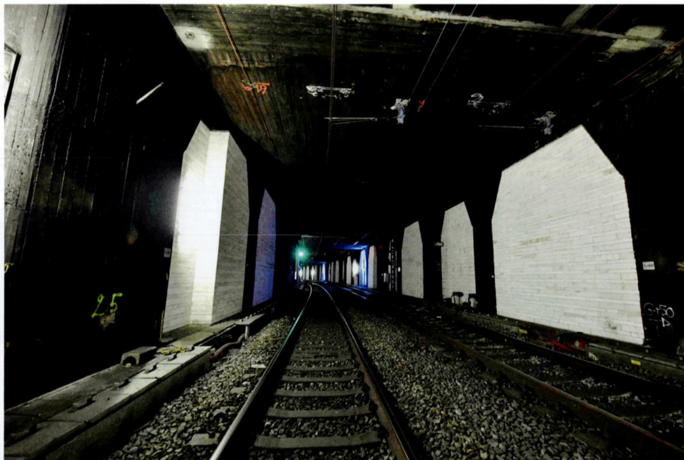
L'intérieur d'un des trois pertuis de la Jonction Nord-Midi. On voit bien les alcôves récemment comblées par du briques résistantes au feu. Remarquez également la présence des nouveaux caniveaux de câble, posés le long des caniveaux existants. Photo : Infrabel/ Bart Van Tricht.
