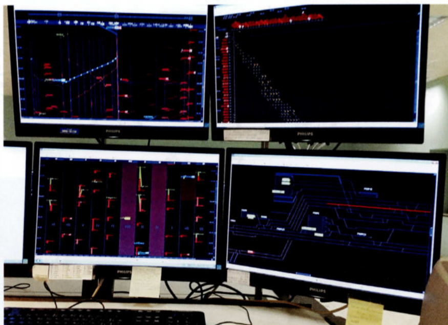
Une console complète du nouveau programme TMS en action, à savoir toute la zone d'action de la cabine de Gand-Saint-Pierre. Ces écrans interprètent la disposition des voies et l'emplacement réel des trains, les graphiques de lignes, l'occupation des voies en gare et le tableau de correspondances!
