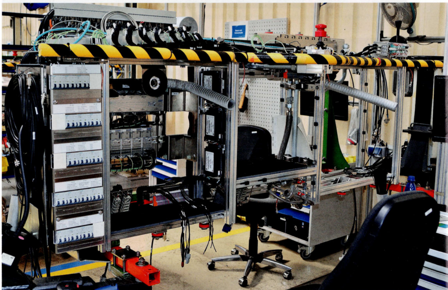
Le dessous d'un pupitre de conduite en cours de montage, au-dessus duquel on aperçoit le bouton d'urgence 'coup de poing', de teinte rouge. Sous le pupitre, une quantité impressionnante d'interrupteurs et d'appareils divers; le tout sera intégré d'une pièce dans la cabine de conduite.
