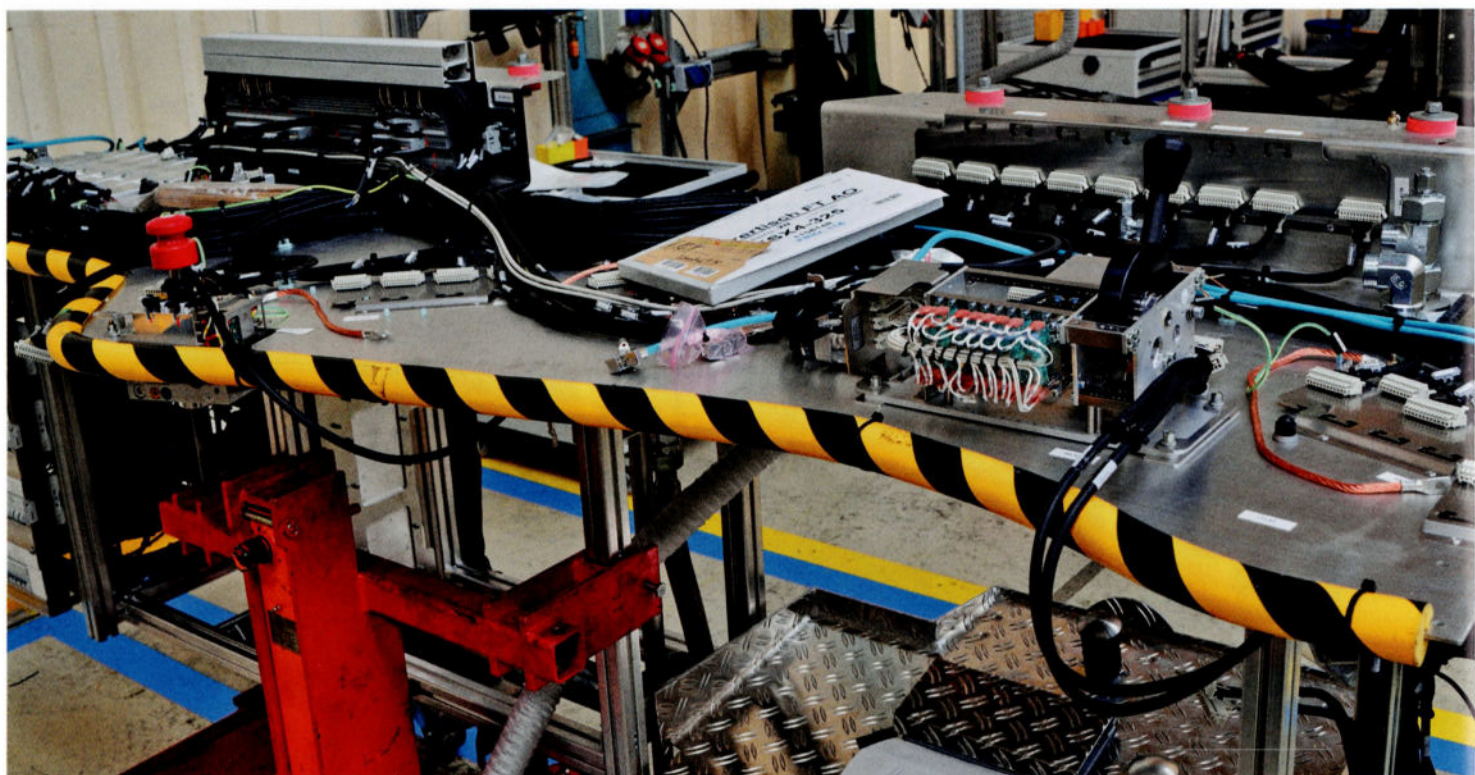
L'assemblage et le câblage d'un pupitre de conduite: le nombre de contacts et de câbles utilisés est vraiment bluffant!
