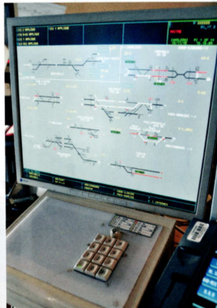
Le poste TCO Vidéo sur le bureau du dirigeant du Block 20, en 2009; l'écran détaillait toutes les installations de la ligne.
