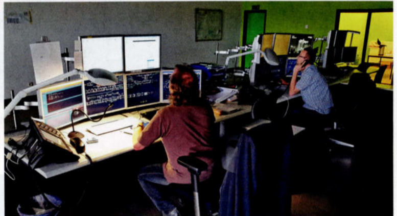
Détaillé au cours d'un article précédent, revenons sur le poste de signalisation informatisé de Denderleeuw, en illustrant cette fois le poste de travail d'où les gares de Burst et Zottegem sont désormais gérées.
