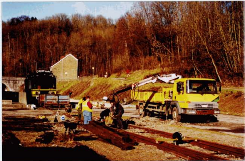
En décembre, des traverses furent remplacées à hauteur de l'ancien aiguillage de Spontin. Les opérations sont grandement facilitées grâce à l'autorail ES 102 et à l'acquisition d'un camion et d'une grue rail-route.
