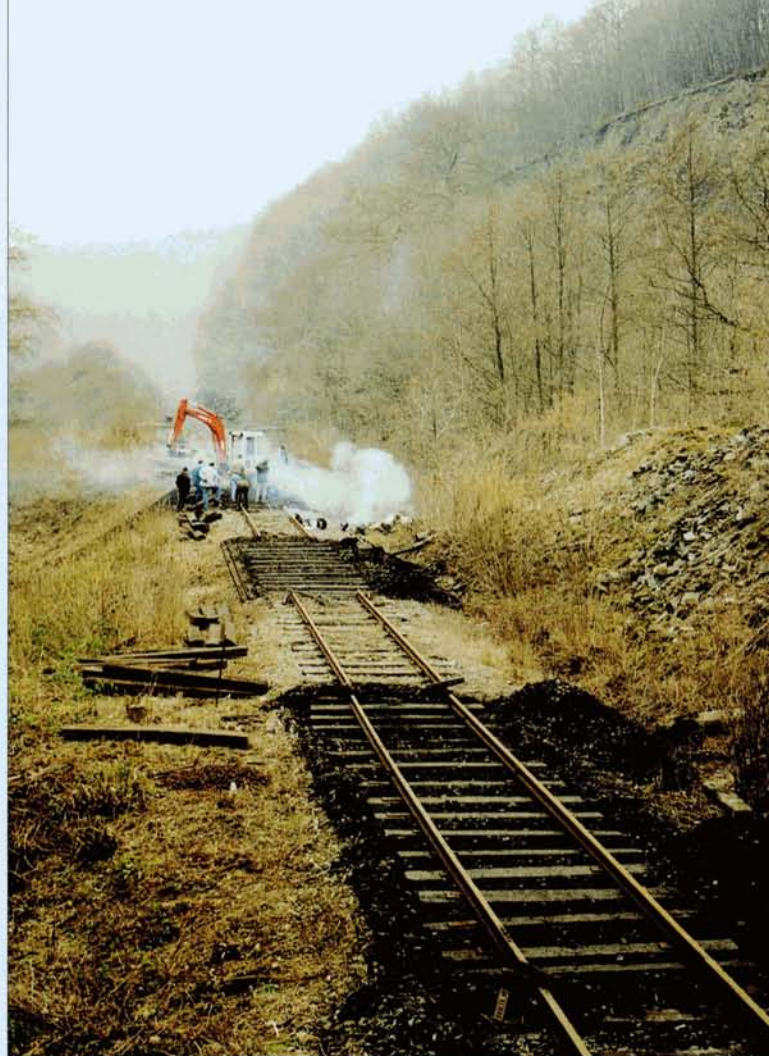
Les travaux de pose de la nouvelle voie à la sortie de la gare de Dorinne-Durnal. Alain DEFECHEREUX.
