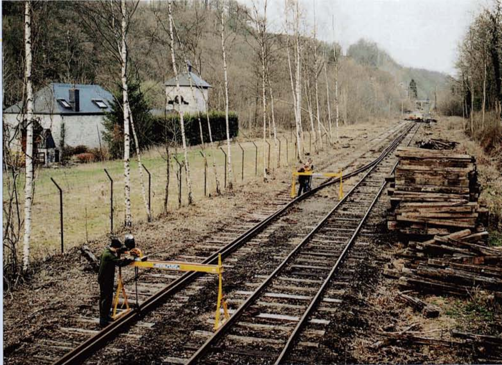
Le PFT au travail à Dorinne-Durnal, le 6 avril 2003. L'équipe s'affaire au démontage des rails de la voie 1. Alain DEFECHEREUX.
