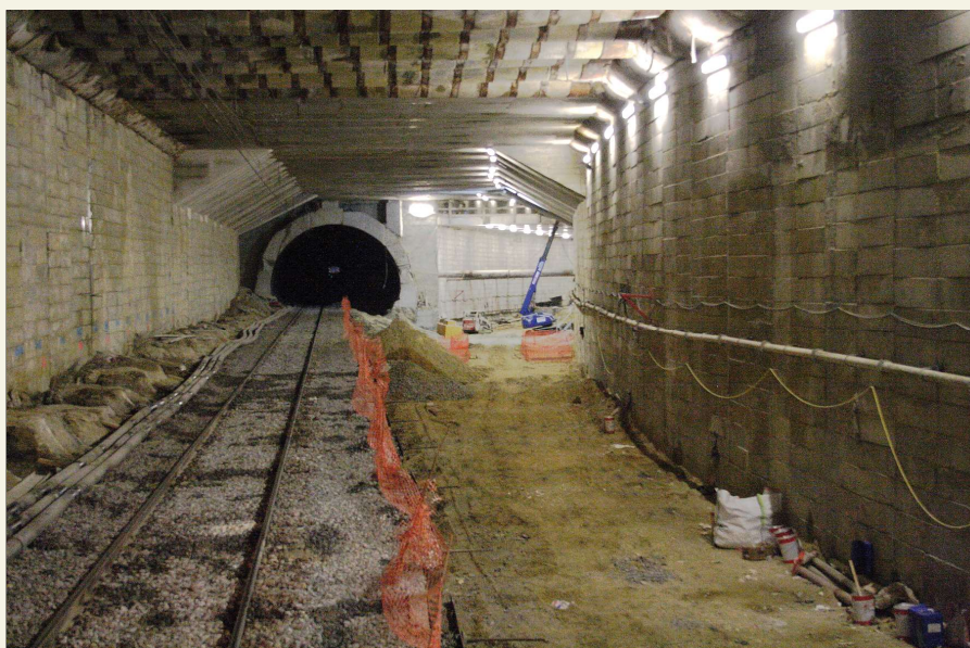
De aansluiting van de Schuman-Josaphattunnel op de Jubelparktunnel. De foto werd op 22 juli 2012 genomen in de richting van Halle. Het rechtse spoor (richting Vilvoorde) werd tijdelijk verwijderd.
