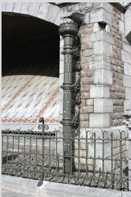
Detail van een waterspuwer met smeedijzeren zuil voor de opvang van het regenwater.
