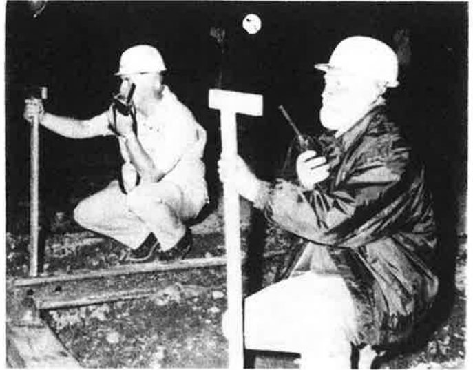
Les ingénieurs, "talkie" à la main, vérifient le niveau et la planéité de l'assise de la voie avant la pose des traverses.
