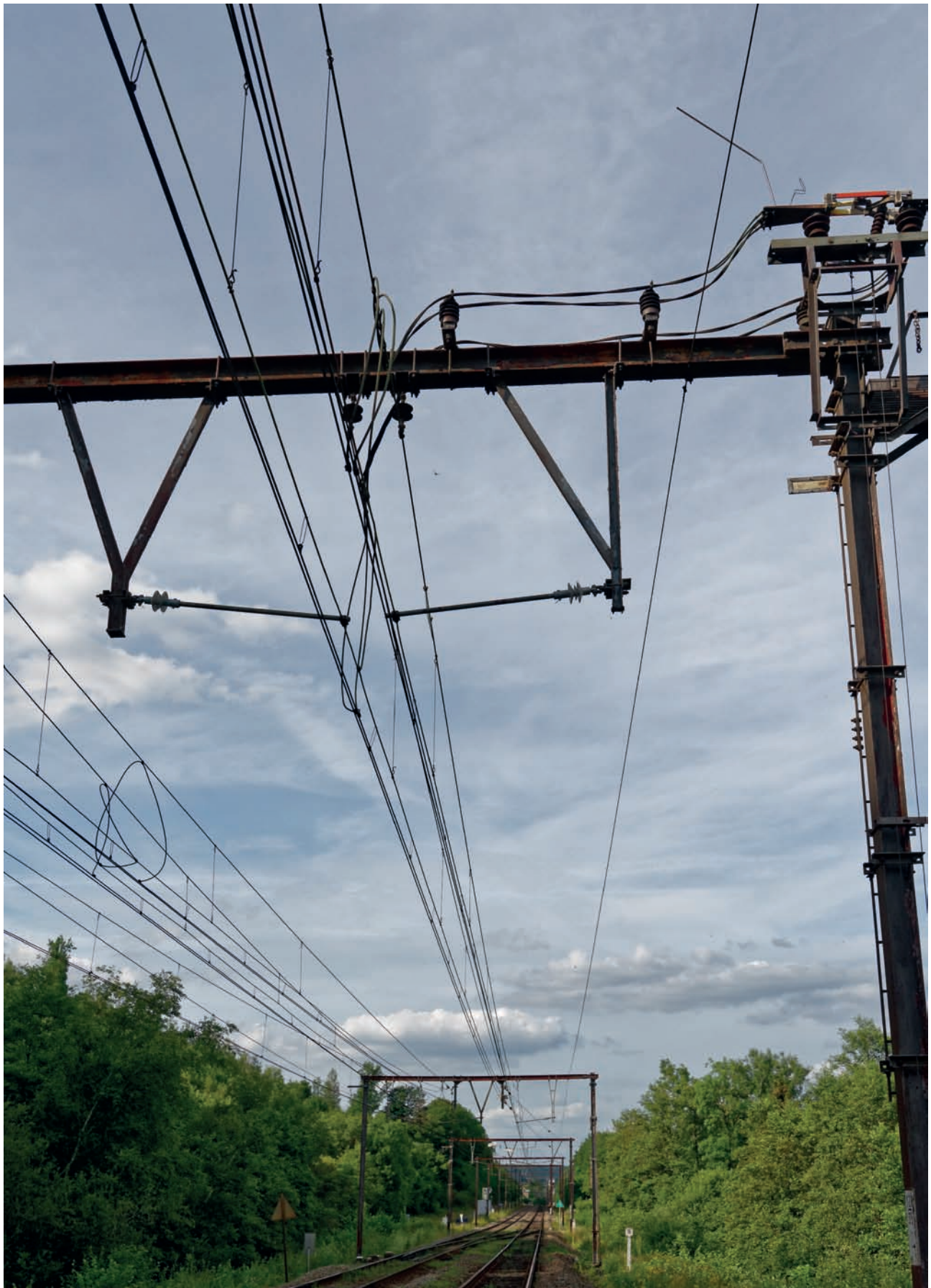
Ligne 162 à l'entrée de Grupont – sectionnement à lame d'air (voie A) – portique d'axe avec interrupteur
