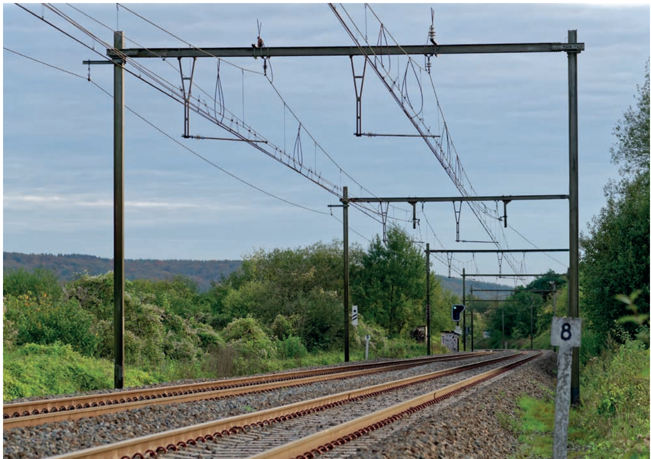
Ligne 162 entre Marloie et Jemelle – sectionnement mécanique sur les deux voies – au premier plan, le portique d'axe
