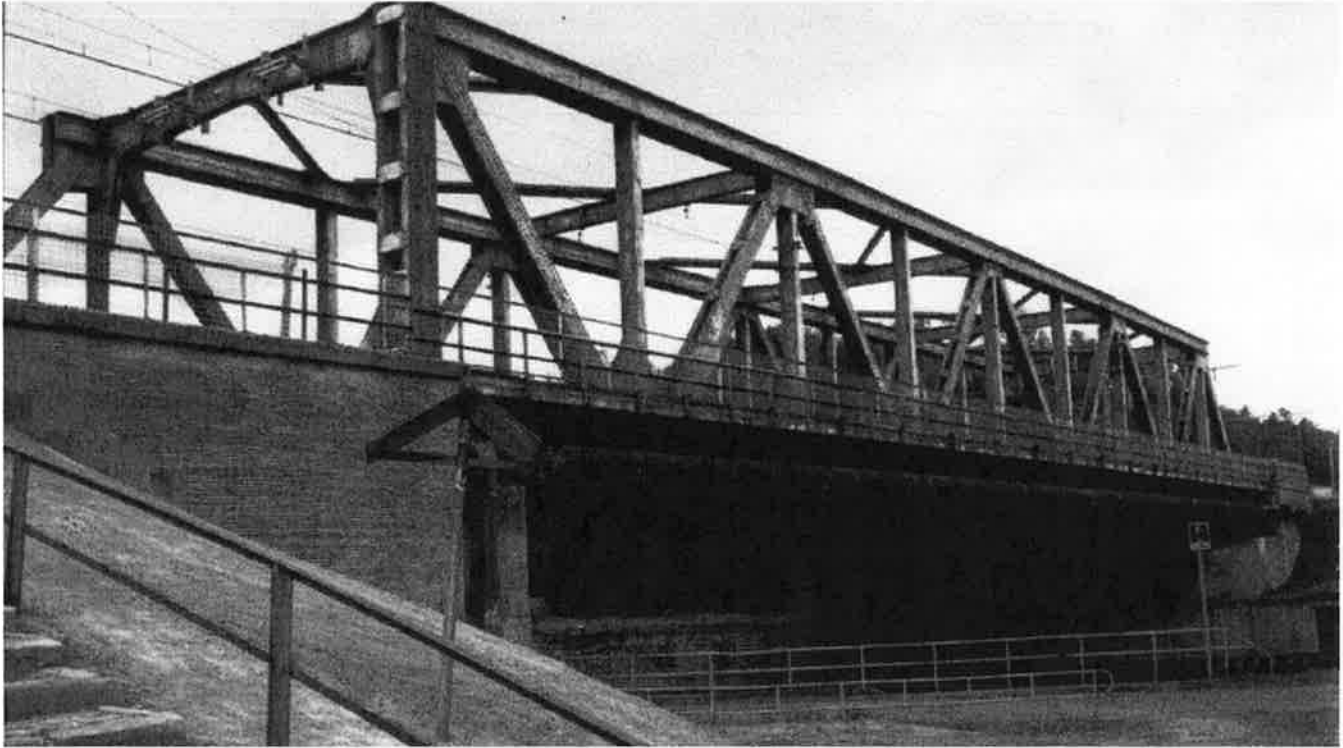
Pont métallique ferroviaire jeté sur la Sambre à Auvalais sur la ligne 130 Charleroi - Namur.
