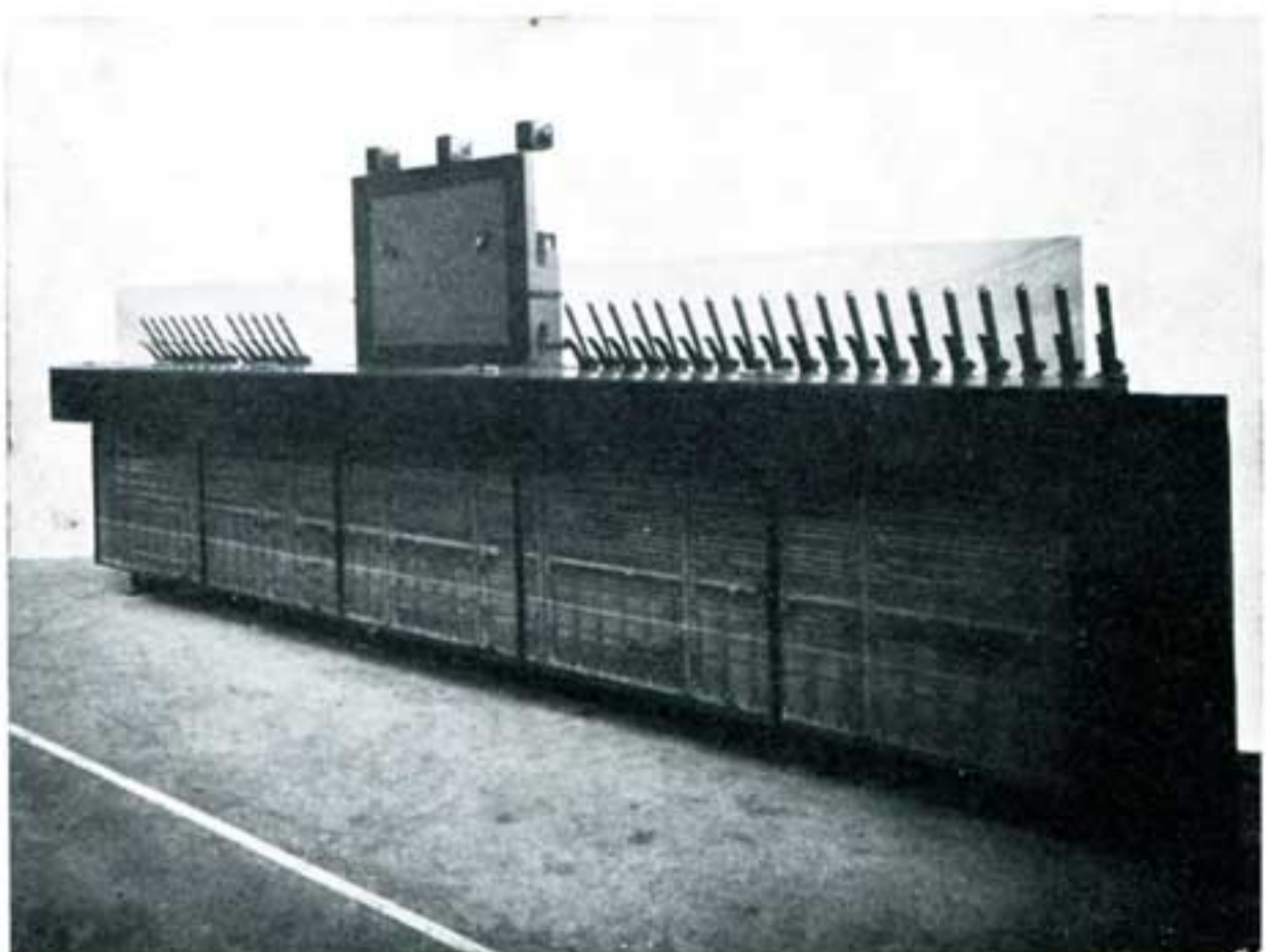
Appareil central de commande mécanique par doubles fils des aiguillages et des signaux. Vue arrière montrant les enclenchements.
