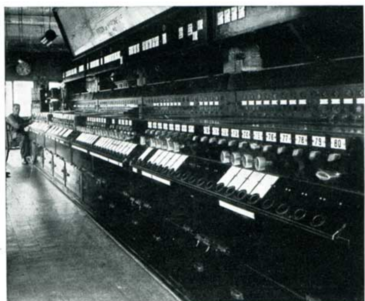
Cabine de Marcinelle. Vue intérieure.
