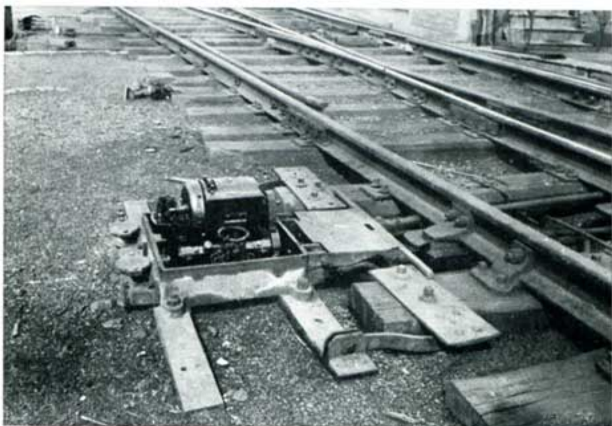
Appareil de manœuvre électrique talonnable pour aiguillages à crochets (couvercle enlevé).
