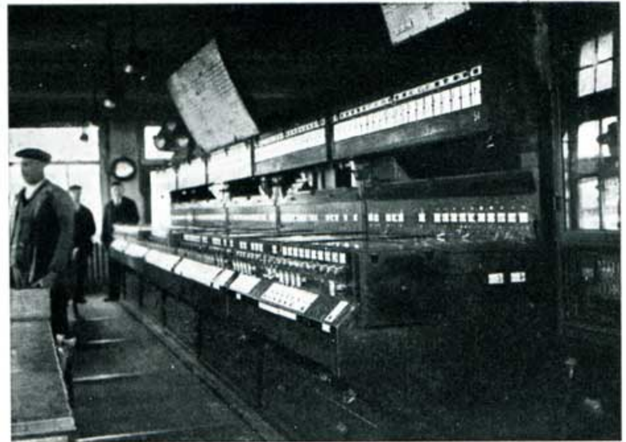
Cabine II de Schaerbeek. Vue intérieure.
