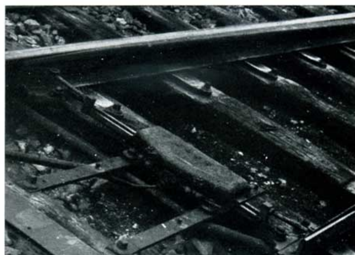
Détecteur de pointes d'aiguilles sans verrou (dans la voie).
