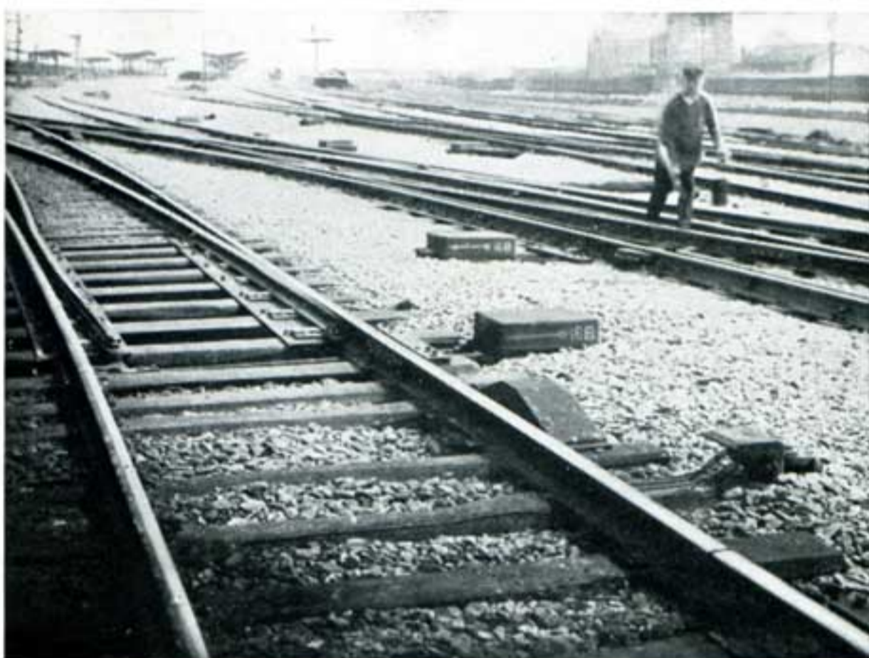
Appareils de manœuvre électrique talonnable d'aiguillages à crochets, installés dans la gare de Schaerbeek.
