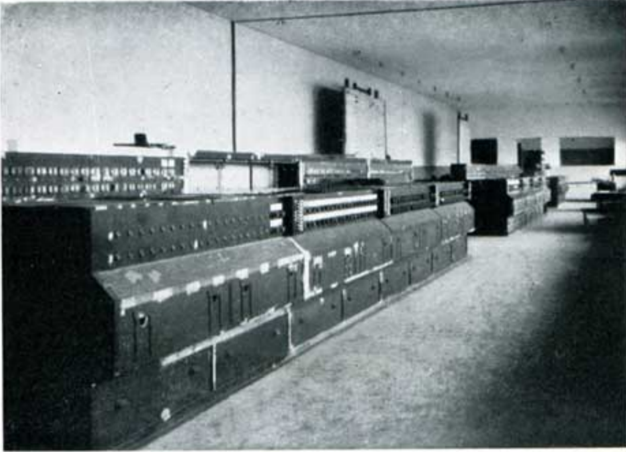
Cabine électrique de Bruxelles-Nord en cours de montage. Appareils pour la commande des aiguillages et signaux par leviers d'itinéraires.
