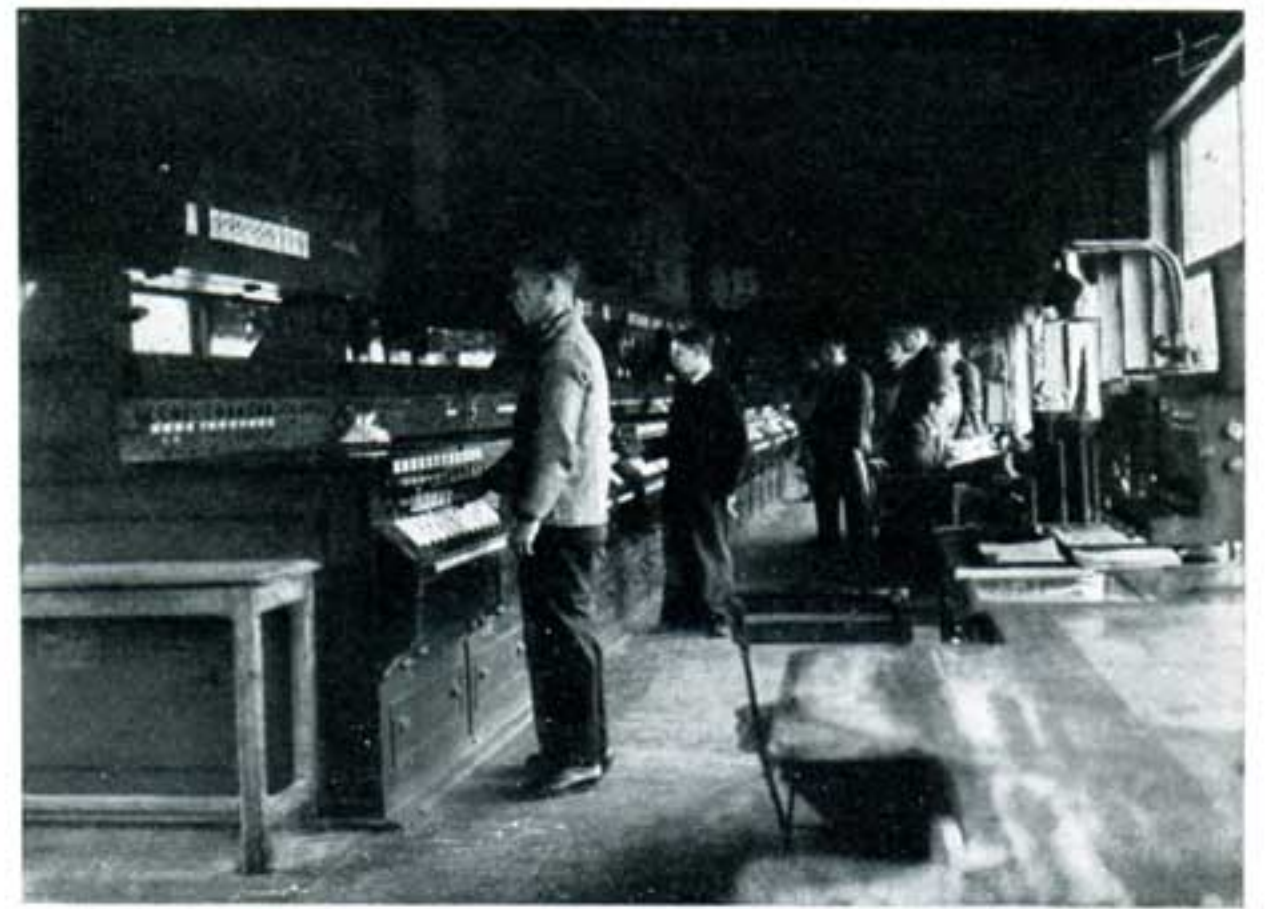
Cabine I de Bruxelles-Nord. Vue intérieure.
